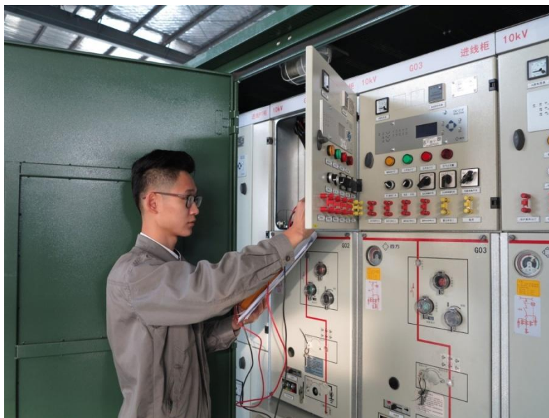
图 7 机械制造与自动化 2017 届毕业生包丹杰在阿富汗 20kV 中低压配网工程部工作
